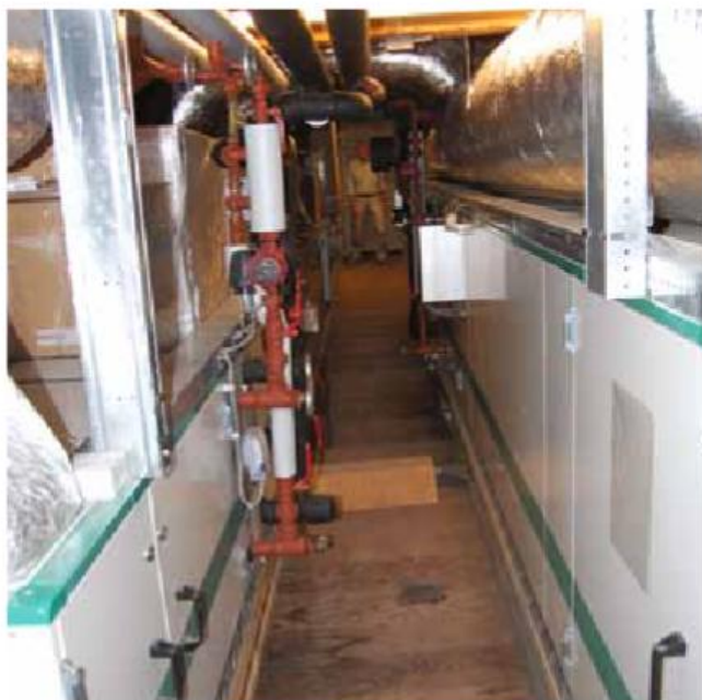
Museumzolder, volledig ingenomen door de klimaatinstallatie. Foto: Bart Ankersmit, ICN Amsterdam
